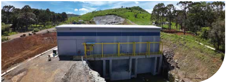
Obras da PCH São Jerônimo Bauarbeiten des Kleinwasserkraftwerks São Jerônimo Works at the São Jerônimo Small Hydroelectric Power Plant
